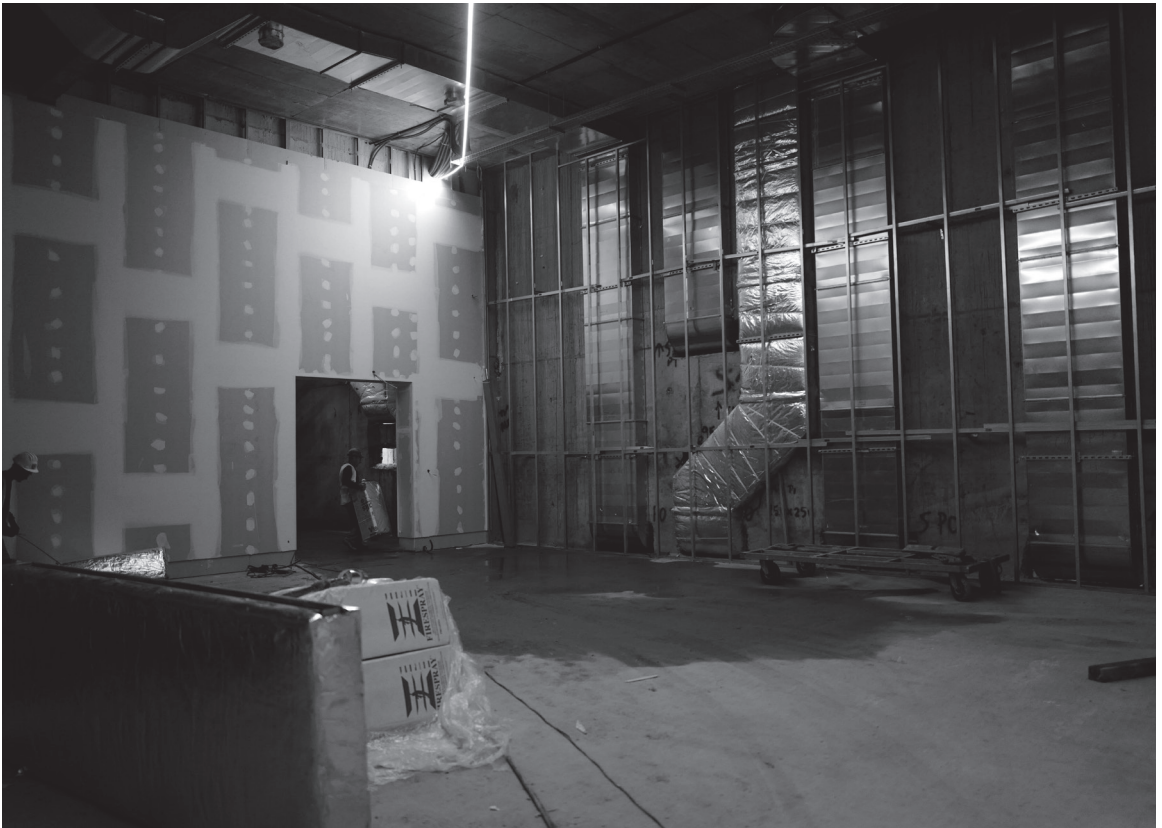
Fotos de obra - montagem das infraestruturas de ventilação na galeria Fotos de obra - montagem das infraestruturas de ventilação na sala
